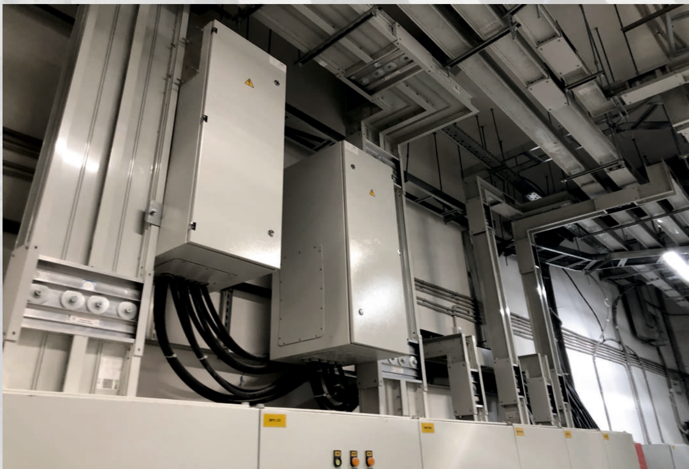
ЖК «Макаровский» , г. Екатеринбург Распределительный шинопровод 3200А, 2000А, 1600А, 1000А
