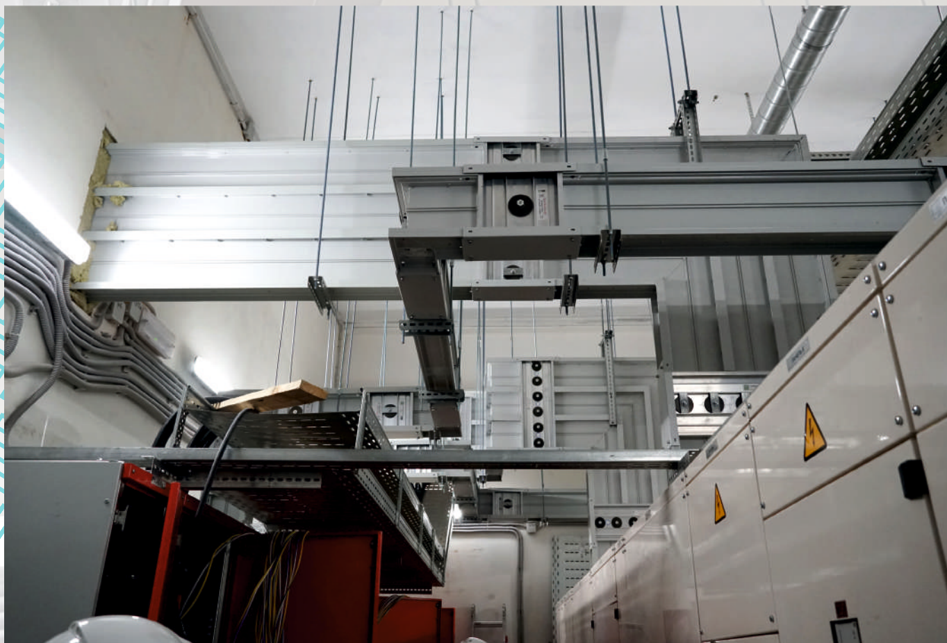
Конгресс-центр МВЦ «Екатеринбург-ЭКСПО» Магистральный шинопровод 6300А и 2000А
