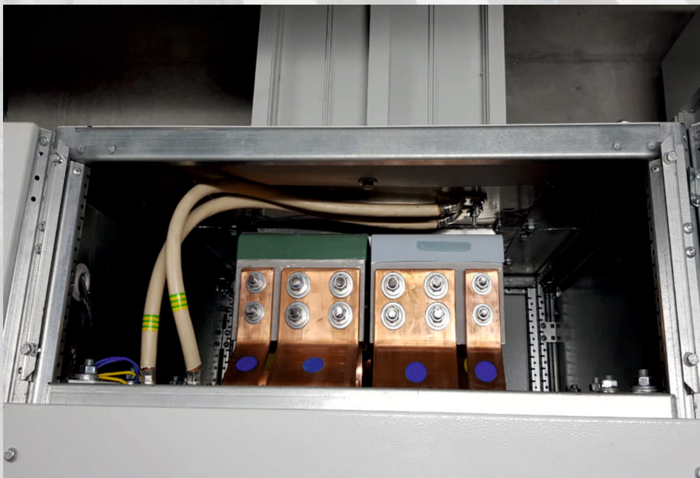
ТРК «КОСМОС», г. Челябинск Магистральный шинопровод 2500А
